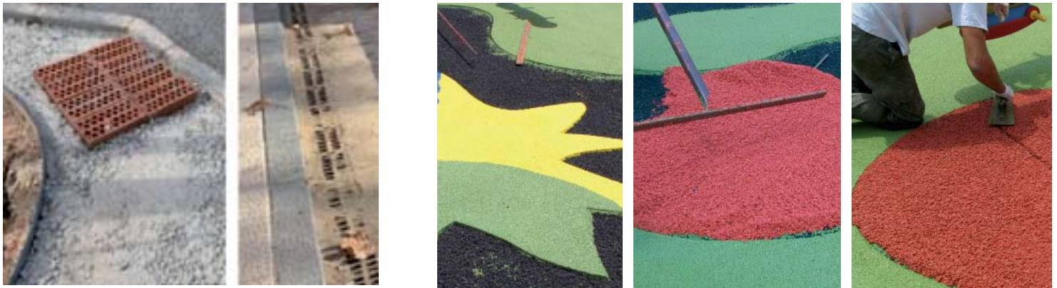
Prever drenaje debajo del pavimento
